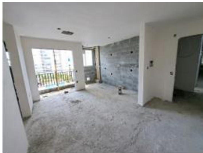
Foto 14 - Alvenaria, gradil, gesso, caixilho e inst. hidr. - 8º pav. Campo Belo "AB" - Torre ou Condomínio 01
